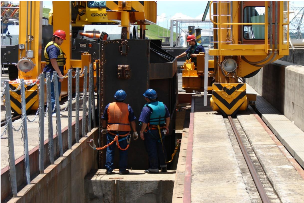
Figura 2. Grúa Pórtico Descarga/ Ataguía
