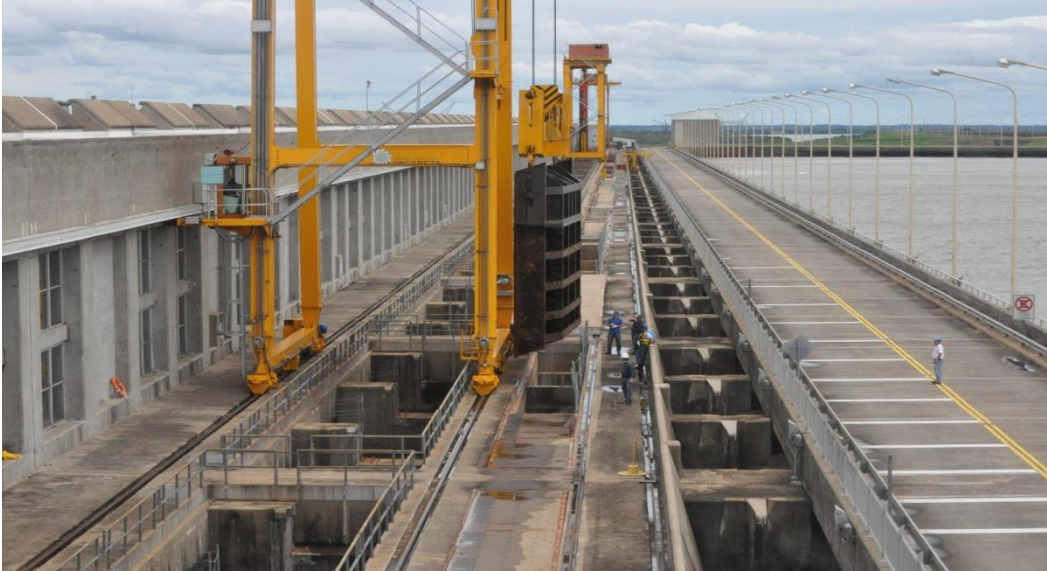
Figura 1. Grúa Pórtico Auxiliar II - Toma de Agua
