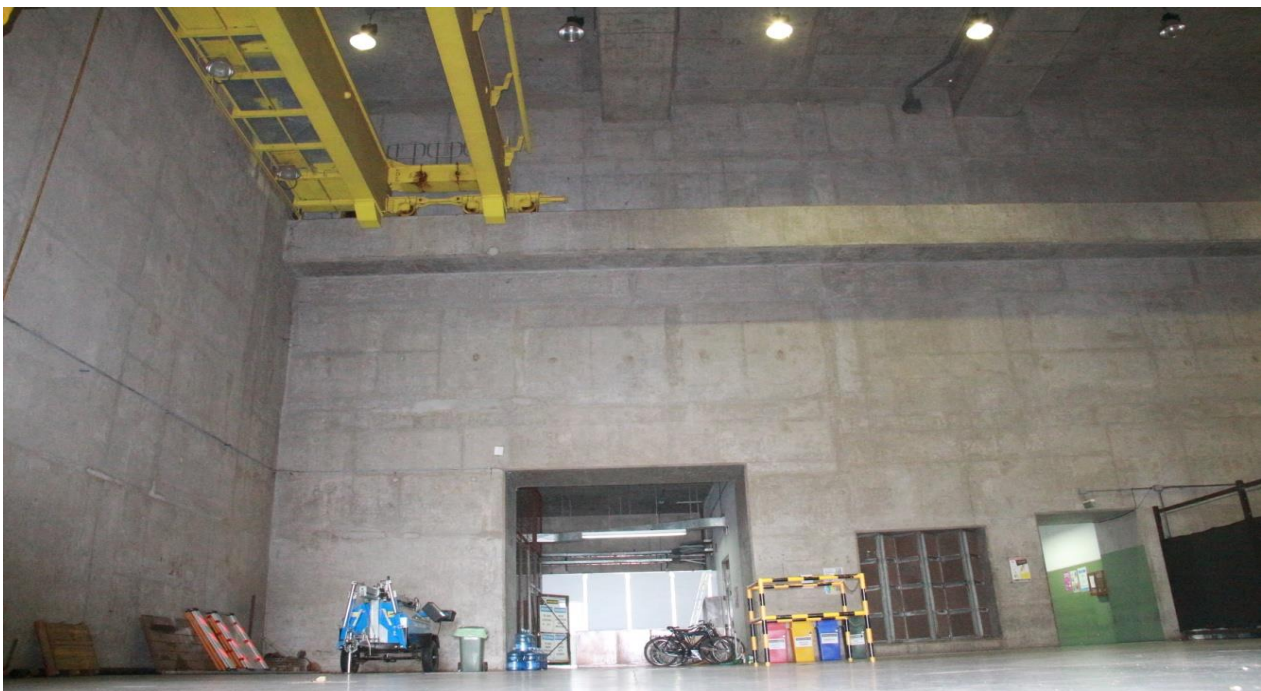
Figura 4. Puente grúa/Recinto Mto. Compuertas
